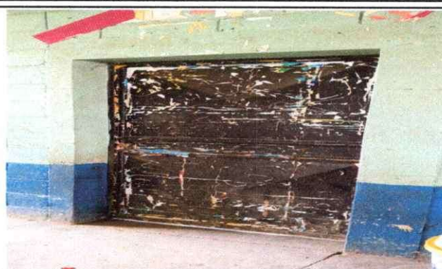
Foto 2: Evidencia del mal estado de las puertas. Según evaluación algunas están para reparación o sustitución. Módulo 4.
