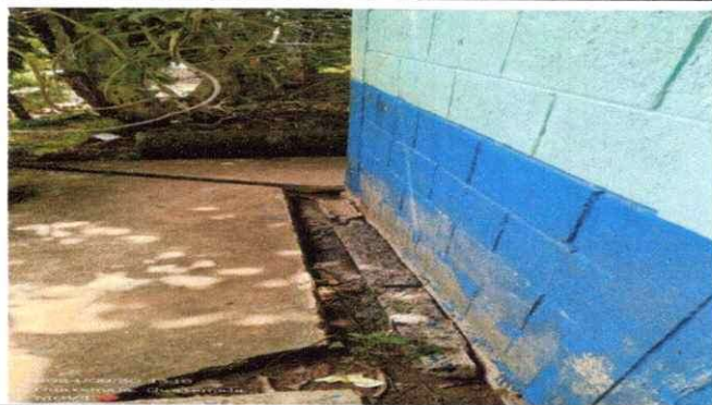
Foto 3: Se evidencia el desprendimiento del concreto a las paredes de las aulas. Módulo 16.
