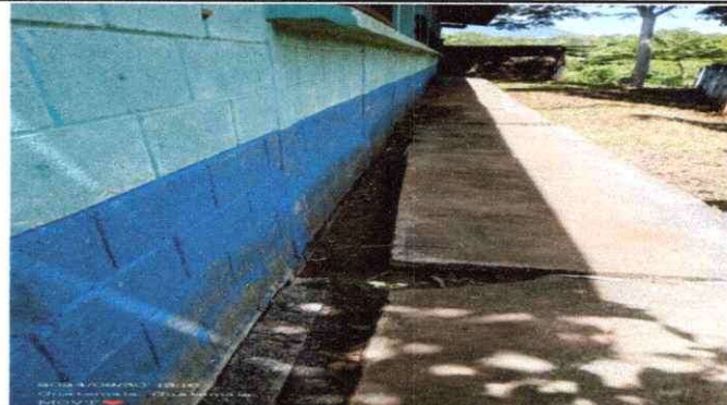
Foto 4: Se identifica el hundimiento del concreto. Módulo 16.
